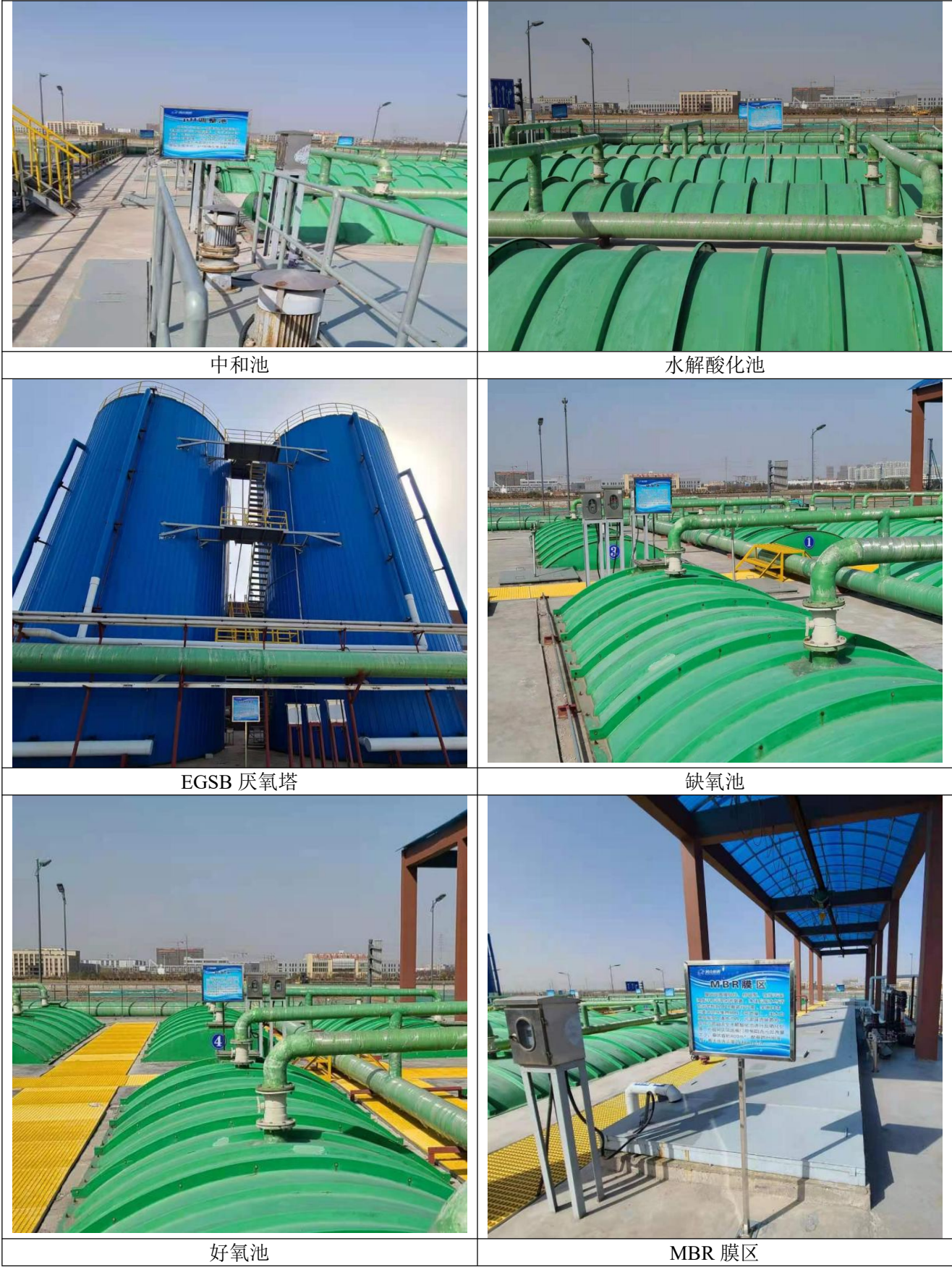
图 4.1-4 废水处理设施照片
